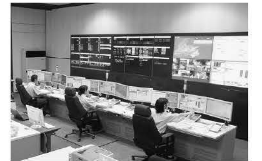
高機能消防指令センター
